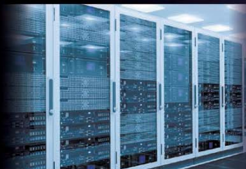
データセンター
